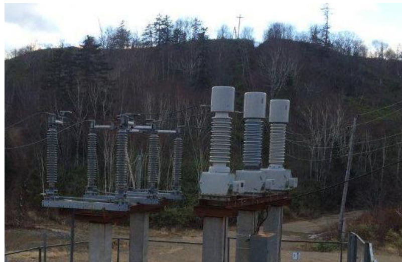
Блок присоединения к ВЛ 110 кВ КТП 110/0,4 кВ на Сахалине
